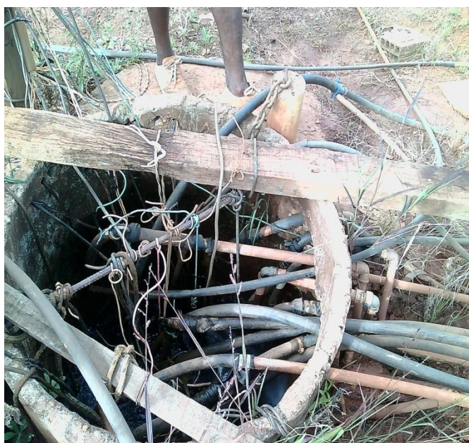
FIGURA 53 – POÇO 6 - LOCALIZADO NA AV. MARCOS FREIRE – REDES DE DISTRIBUIÇÃO EXPOSTAS ÀS INTEMPÉRIES
