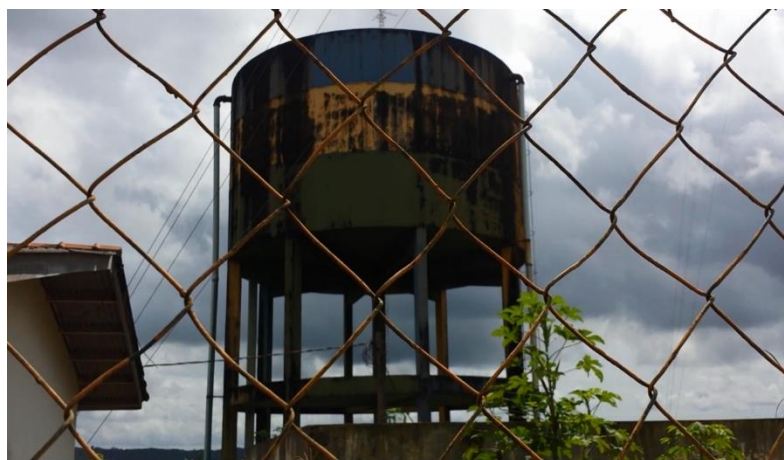
FIGURA 52 – RESERVATÓRIO EM PÉSSIMO ESTADO DE CONSERVAÇÃO EM MEDICILÂNDIA.
