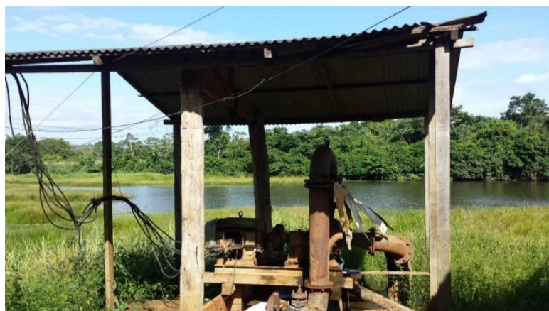
FIGURA 44 – CASA DE BOMBAS EM PÉSSIMO ESTADO DE CONSERVAÇÃO EM MEDICILÂNDIA. – P7 (FONTE: AUTOR, 2016)
